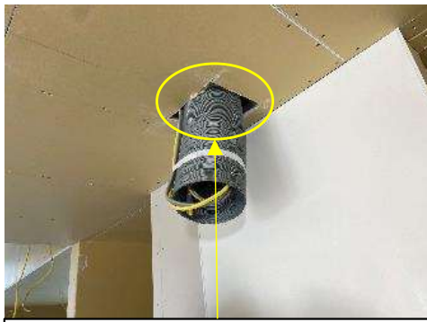
キッチンの排気ダクト回りの隙間を是正することをお勧めします。
