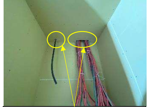
分電盤配線の取り出しの隙間を是正することをお勧めします。
