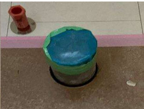
排水管周りの隙間を是正することをお勧めします。
