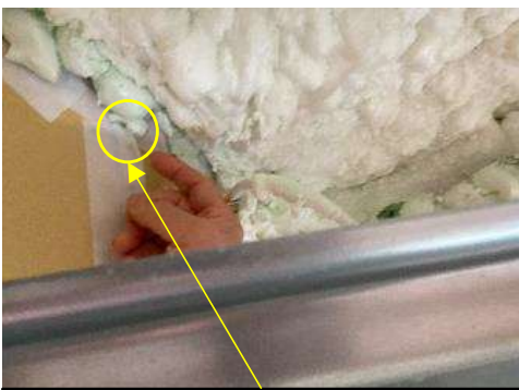
吹付断熱材とボードのジョイントから漏気がありましたので、是正することをお勧めします。
